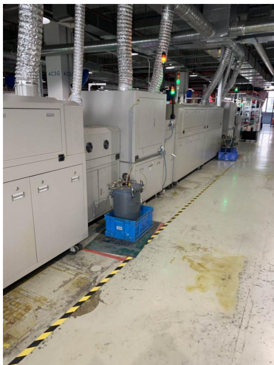
车间废气收集管道
