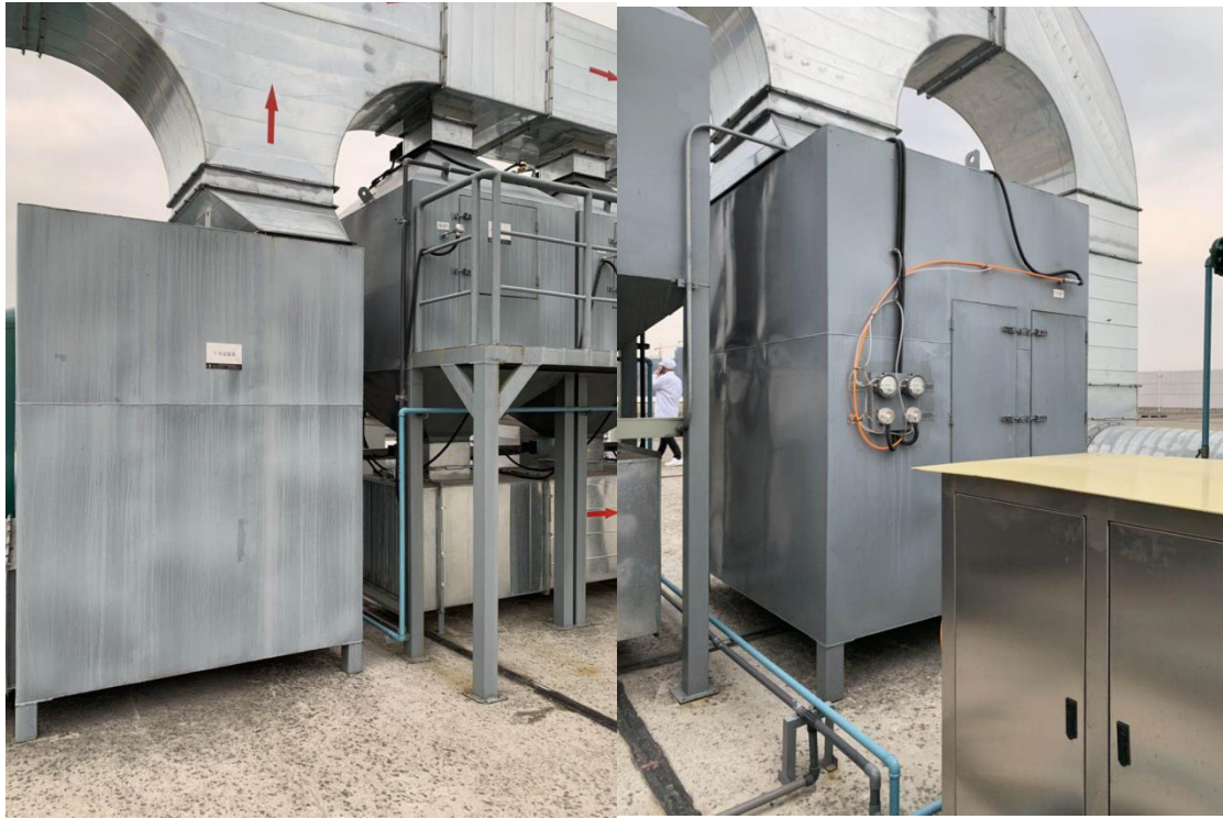
过滤器设施照片
