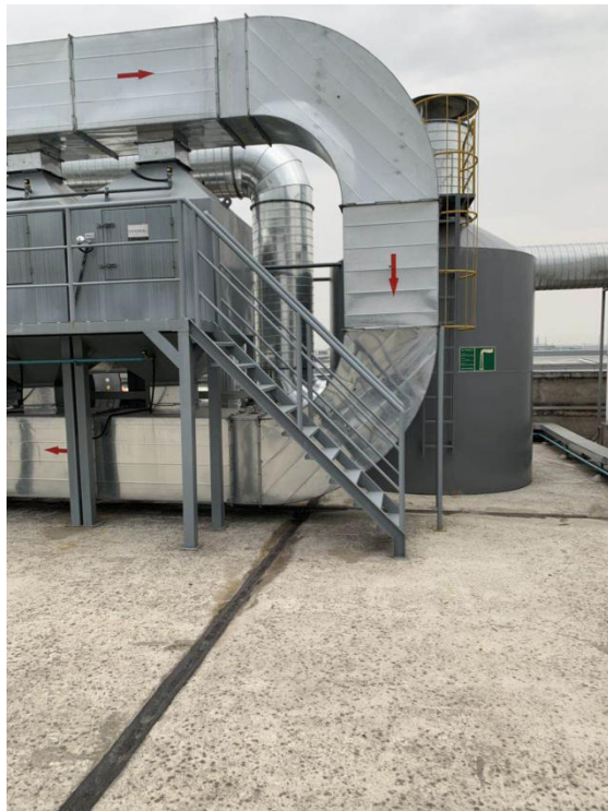
废气收集管道 1
