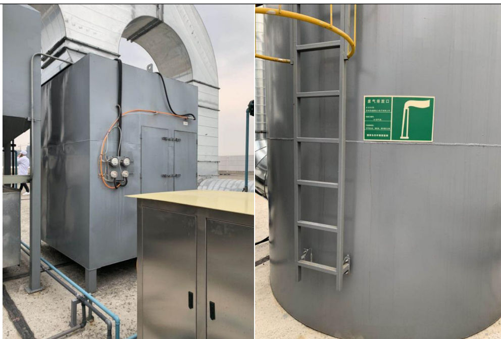
图 3-2 废气治理设施
