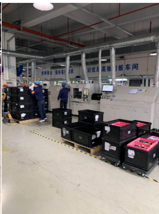
车间废气收集管道
