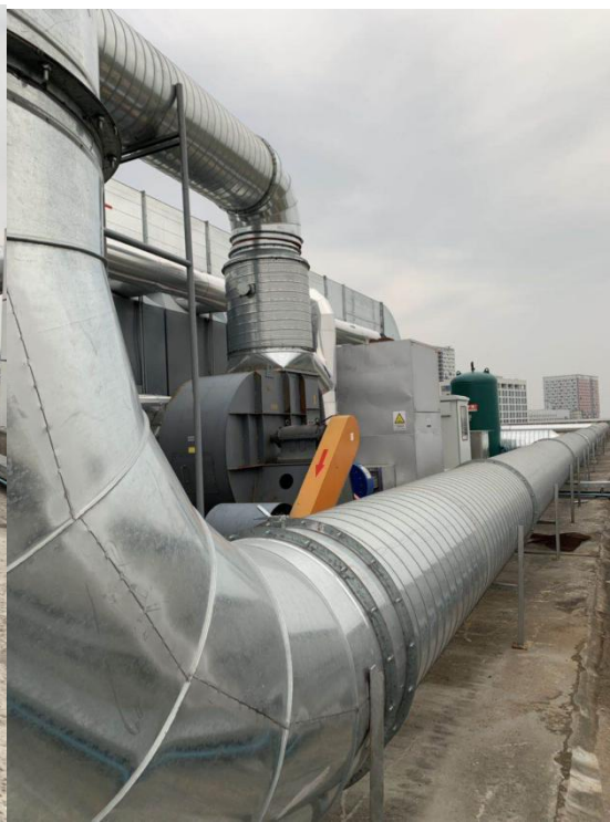
废气收集管道 2
