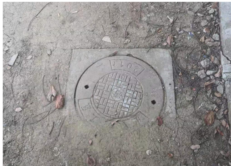
图 1-5 污水进入出口加工区管网排口
