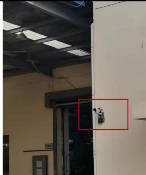
危废间外部监控
