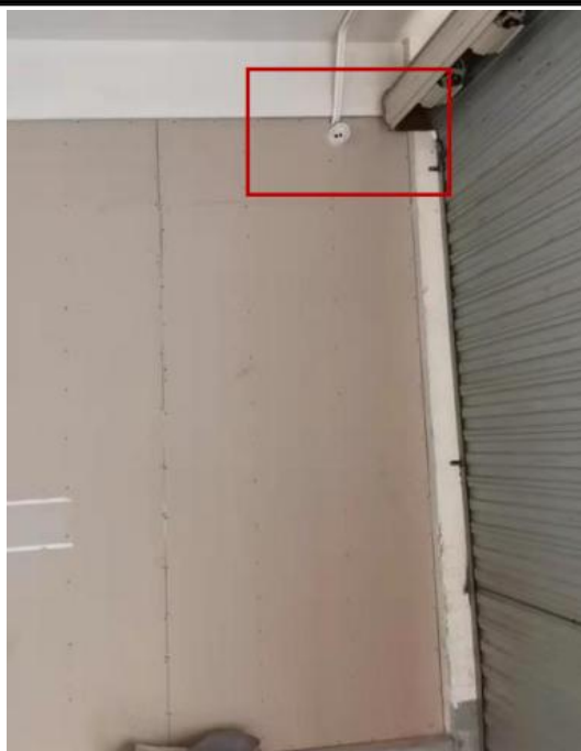
危废间内部监控
