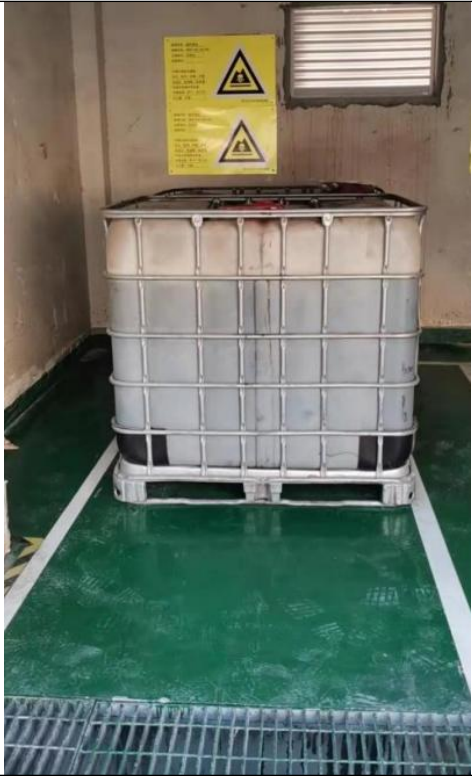
危废间内部标识牌、导流槽
