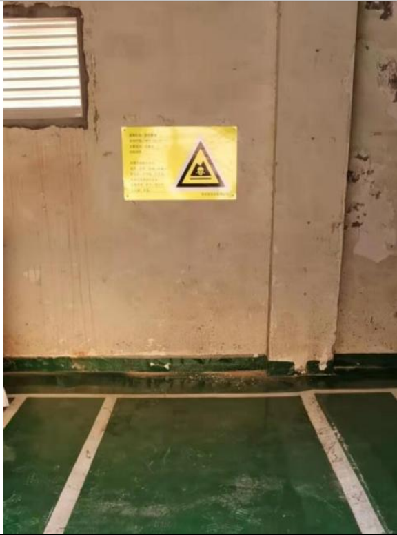
危废间内部标识牌、防渗地坪
