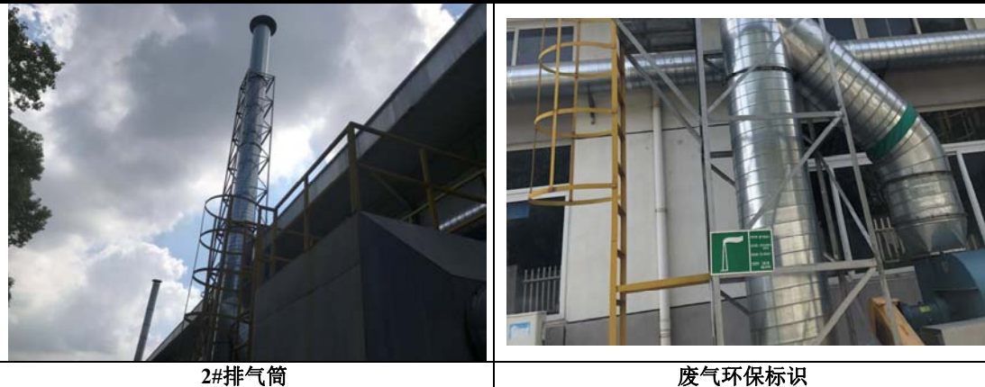
图 3-3 废气处理设施及排气筒
