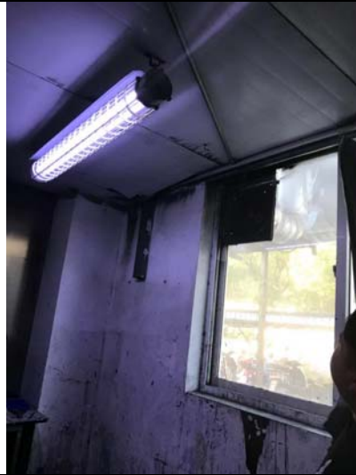
调漆废气收集装置
