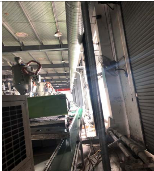
废气输送管道
