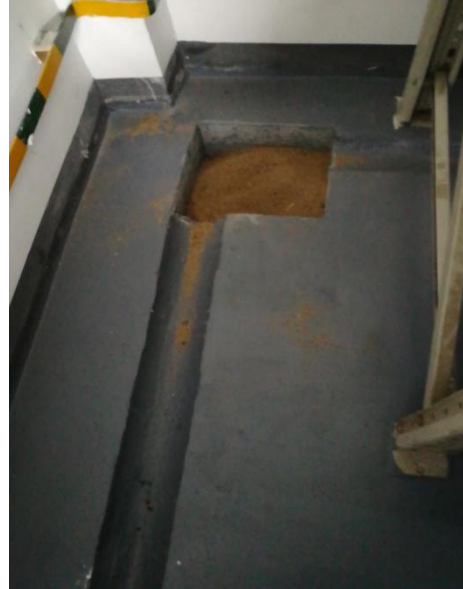
导流槽和收集池
