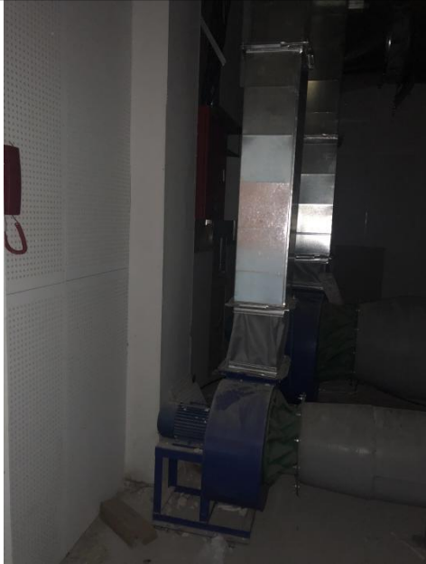
地下车库内风机及隔音屏
