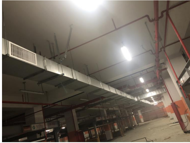
地下车库通风系统
