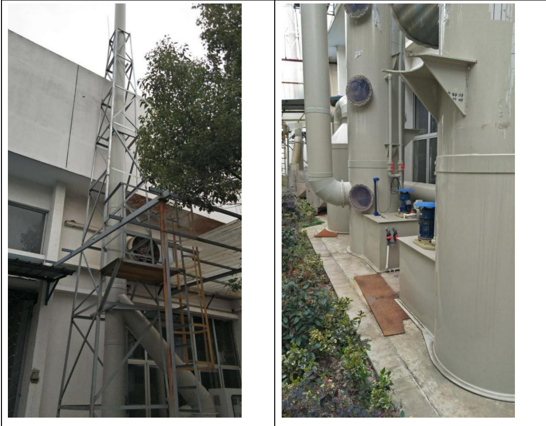
图 3-2 废气处理设施现场照片
