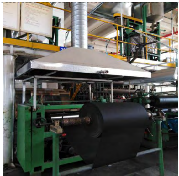
涂胶废气收集措施
