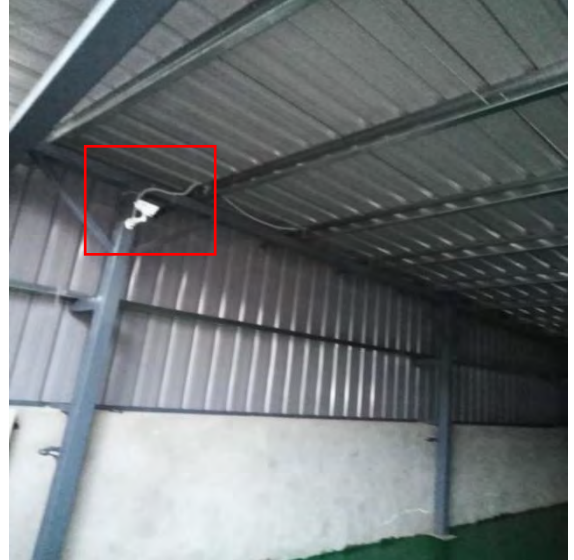
危废库内部监控
