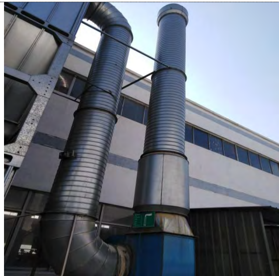
1#(布袋除尘器)排气筒
