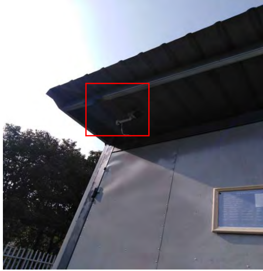
危废库外部监控
