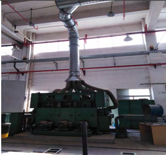
裁边粉尘废气收集措施
