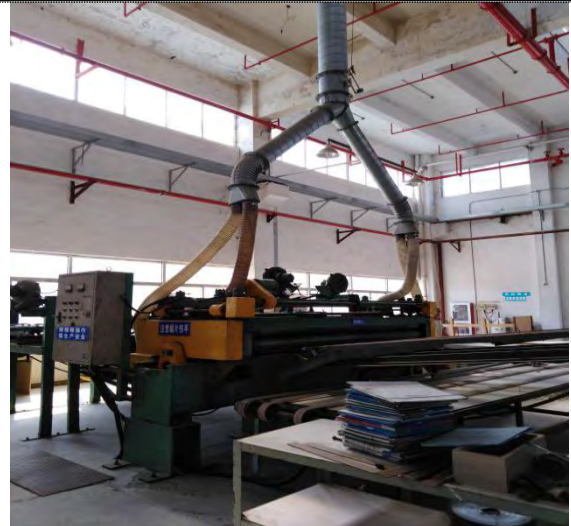
砂光粉尘废气收集措施
