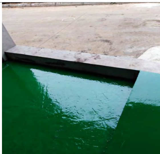
危废库门口围堰
