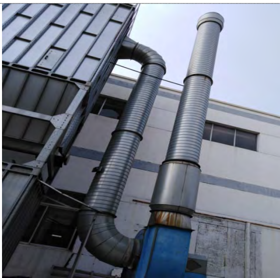
2#(布袋除尘器)排气筒
