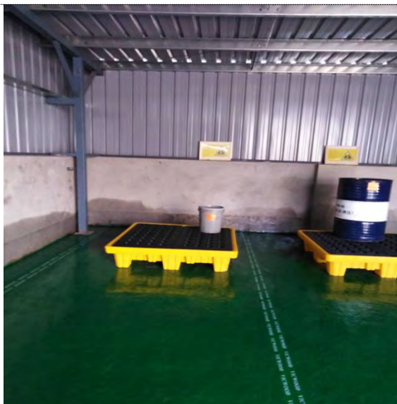
危废库内部环氧地面、分区线、标志、托盘等
