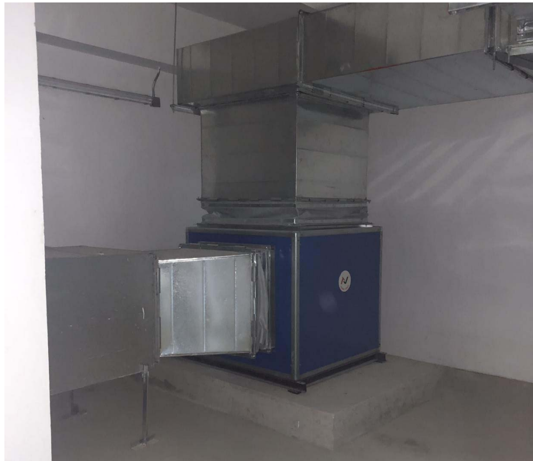
地下车库内风机
