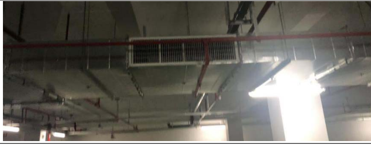
地下车库通风系统
