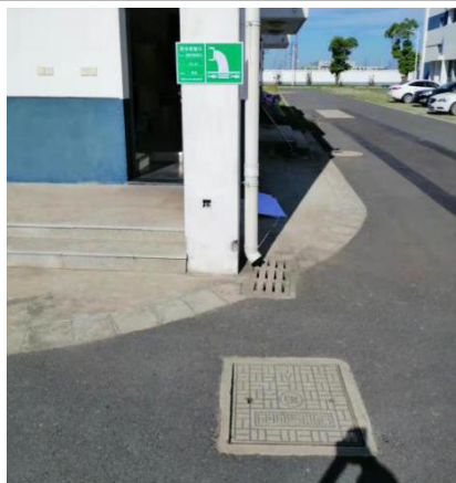
图 3-4 雨水排口标识牌
