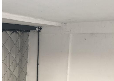
图 3-6 危废仓库内部监控照片
