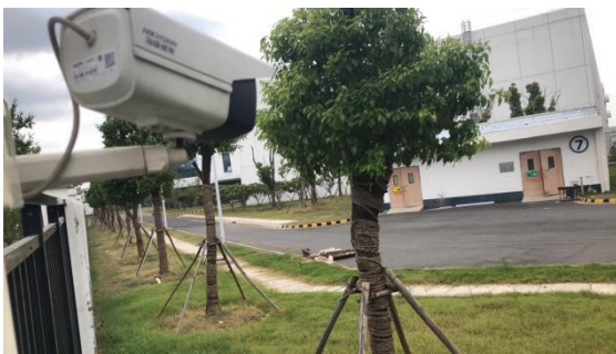
图 3-5 危废仓库外部监控照片
