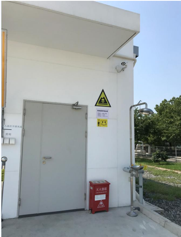
危废仓库（门口贴了危废仓库的标识、安装了摄像头、门口放置了洗眼器、防静电装置、灭火器）
