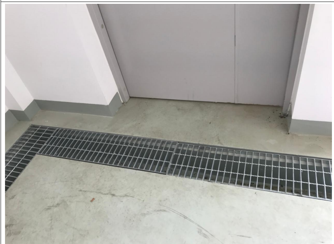
危废仓库地面已做成环氧地坪，仓库四周设置泄漏液体收集沟
