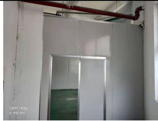
危废仓库内部摄像头
