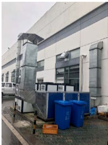
图 3-2 食堂油烟（4#排气筒）照片
