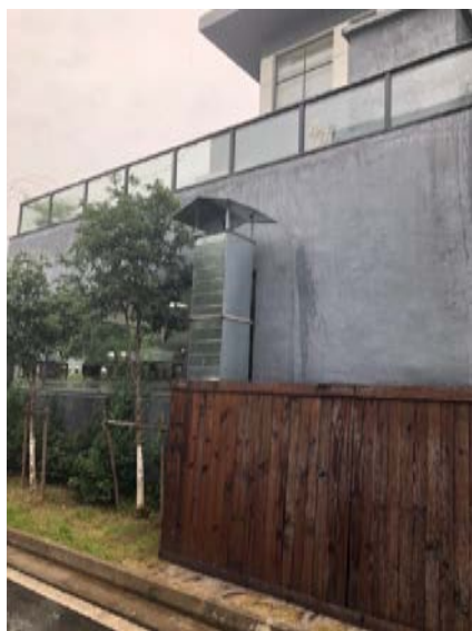
图 3-1 研发区油烟（1#排气筒）照片
