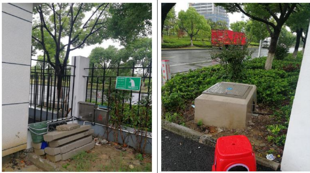
图 2-10 生活污水总排口
