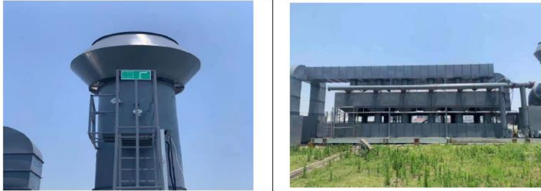
图 2-9 废气处理设施及排气筒 DA001 (1#)
