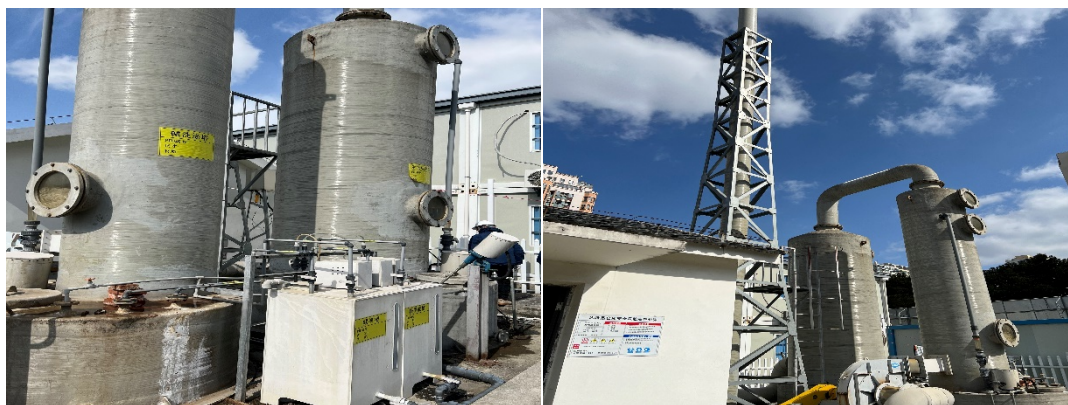
废气防治措施
