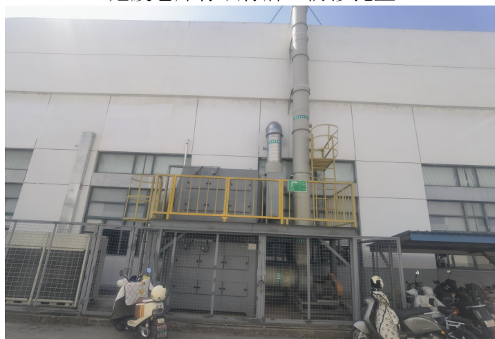
(1#排气筒、废气处理设施)
