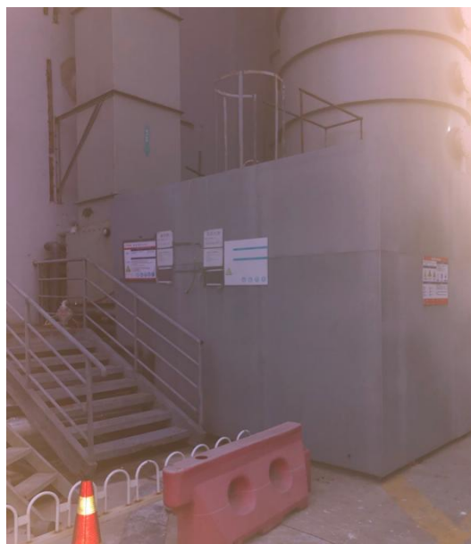
风机水泵降噪隔板
