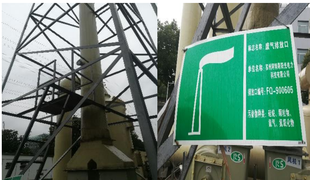
硅烷燃烧+二级碱液喷淋装置
